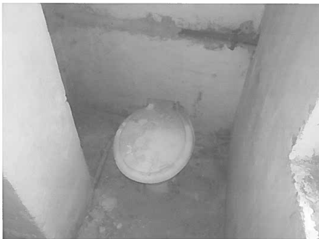
P13: - Kamra: 3, kienet tintuża bhala toilet
