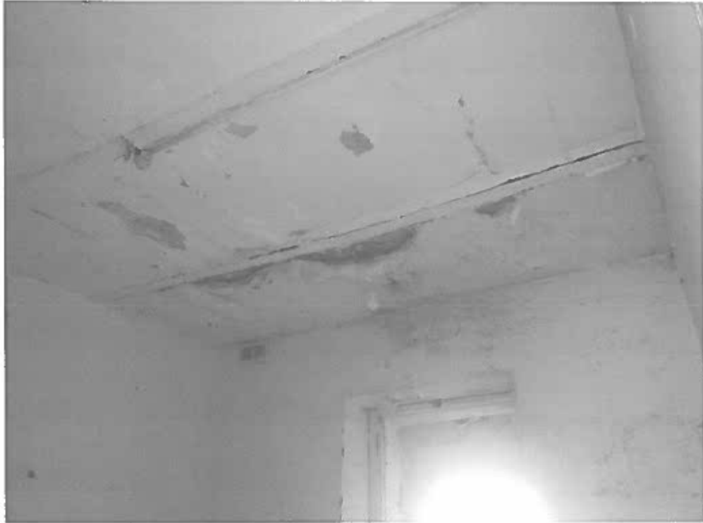
P9: - Kamra: 2, l-ilma li diehel mill-bejt, qiegħed jikkawża ħsara lis-soqfa ta' taħt ta' l-ewwel sular. ġie innutat tqaxxir ta' żebgħa mill-qiegħ tax-xorok u saddid fuq taħt il-travi tal-ħadid.
